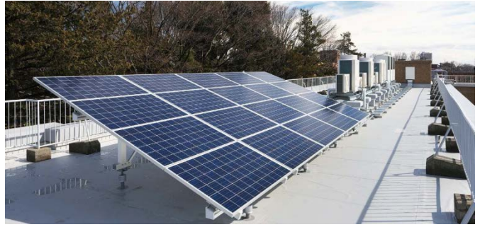
峰町2号館農芸化学棟屋上太陽光発電設備
