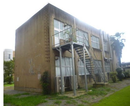
峰町2号館D棟： 建物の老朽化が著しい
